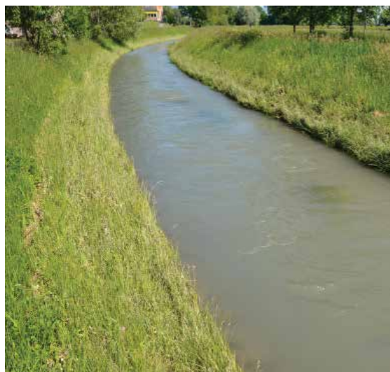
Am Ehbach nach dem Junihochwasser 2013. | Fotos: Benzer
